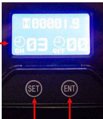
DISPLAY DE AUTOMATIZAÇÃO DO ASPERSOR DE ÁGUA
